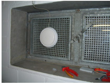
Zuluftventil von innen im Kellerfenster
