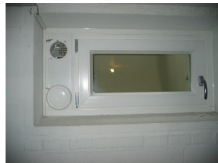
Zuluftventil im Fensterrahmen
